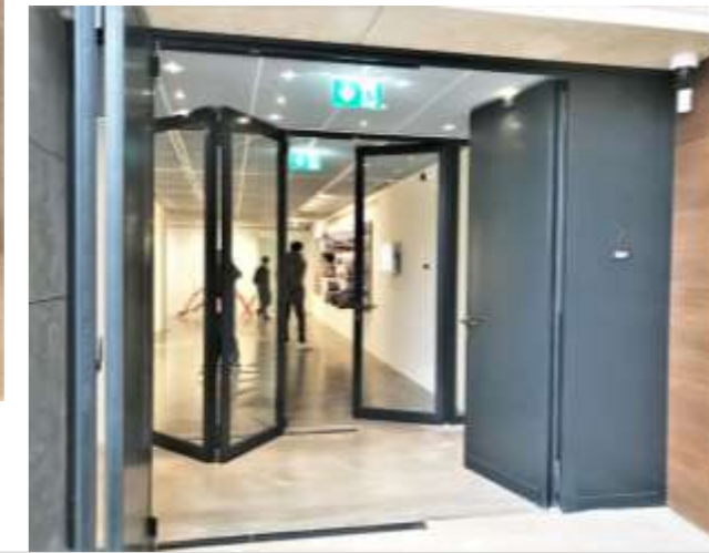
Yapı Kredi Bankası Kültür ve Sanat Merkezi Çelik Kapı Pencere Doğramaları, Beyoğlu-İstanbul
